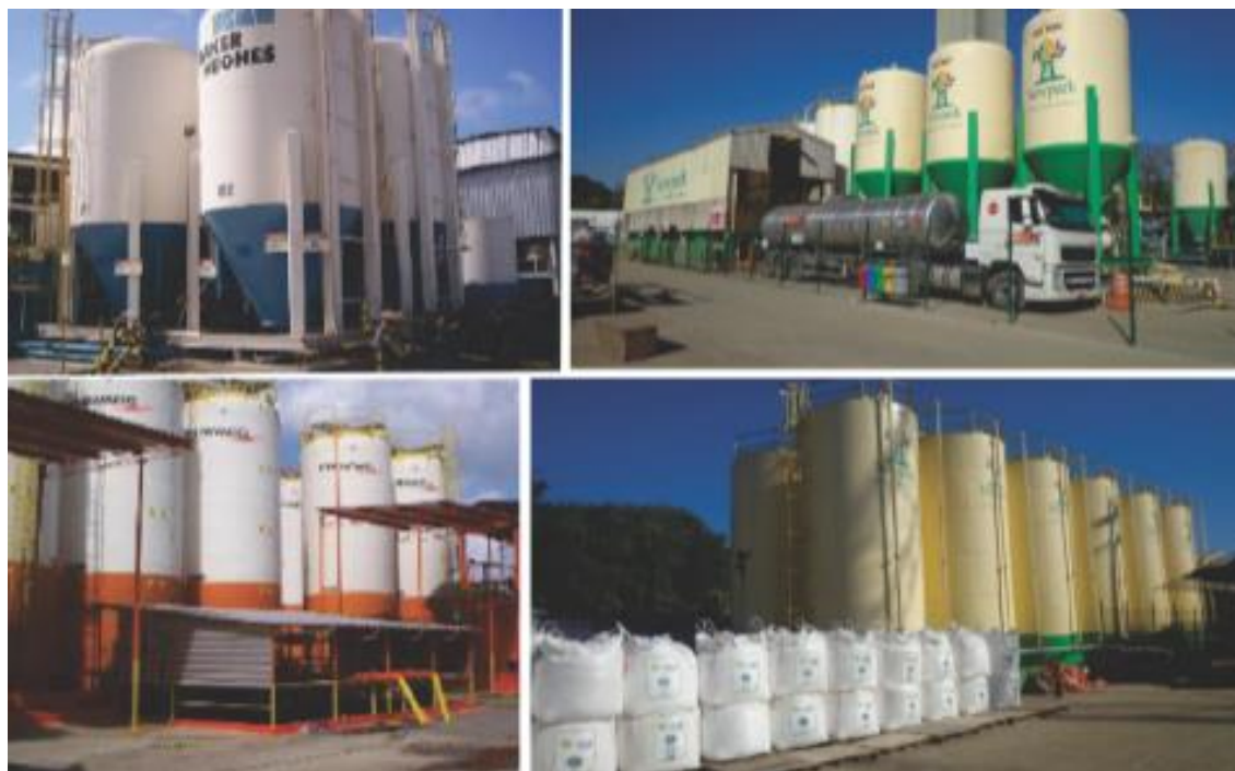
Figura 53 - Tanques do Porto de Niterói Fonte: Plano Mestre do Porto de Niterói (2015)
