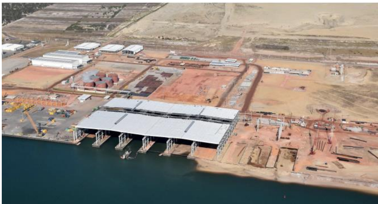
Figura 74 – Base de Apoio Offshore – Edison Chouet - Terminal Onshore T2 Fonte: website do Porto do Açu (acessado em 2018)
