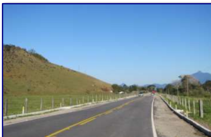
Figura 43 - Condição geral da RJ-155 no trecho compreendido no município de Angra dos Reis
